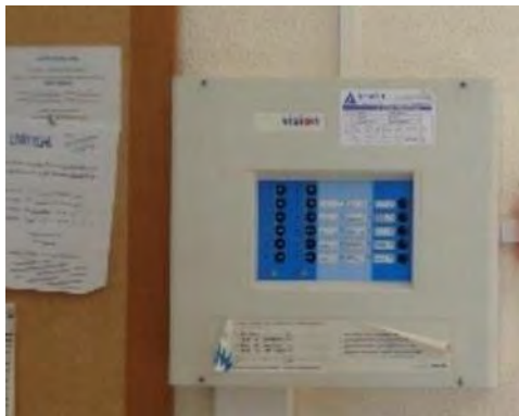
Central de control de incendios
