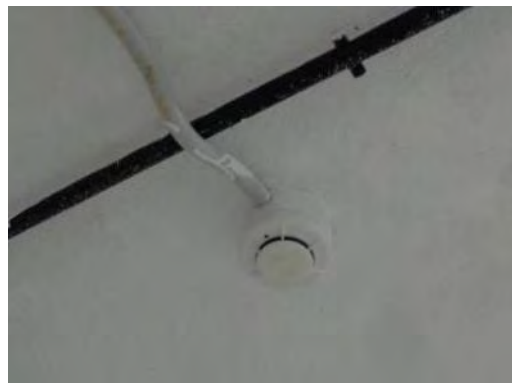
Detector de incendios
