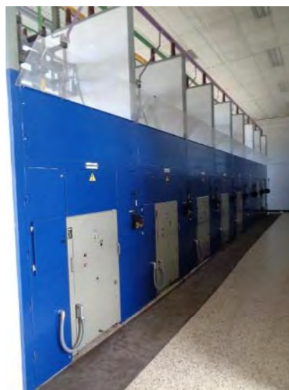
Celdas 15 kV (Convencional)
