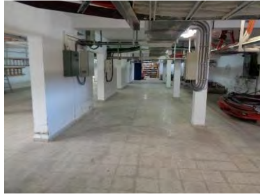
Sótano de cables
