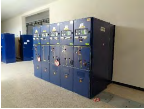
Celdas 15 kV (NXPlus)
