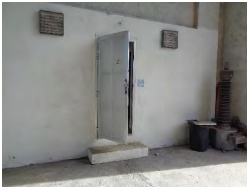
Acceso a Sala de Comunicaciones
