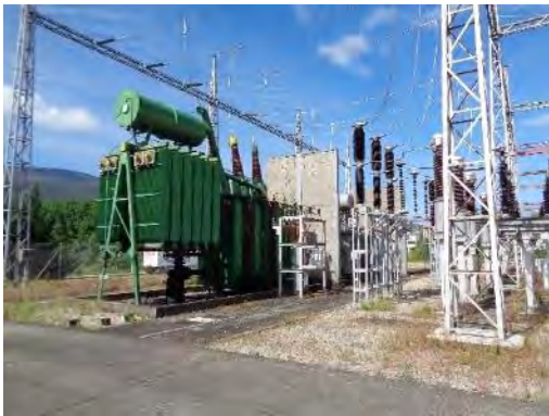
Transformador de potencia
