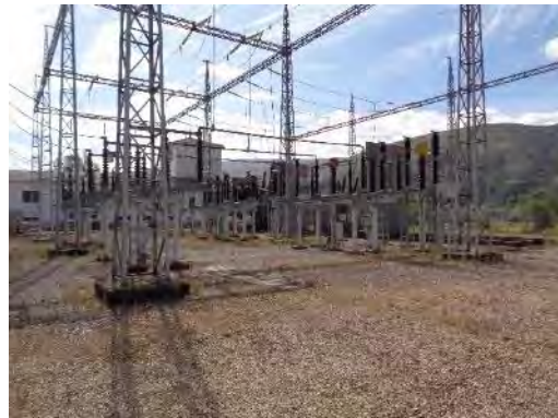
Parque intemperie 132 kV
